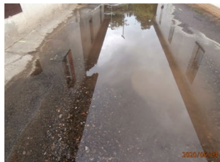
Město neodkanalizovalo dešťovou vodu
